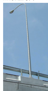
照明設置写真
